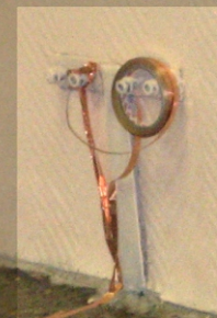
Вывод на контур защитного заземления здания
